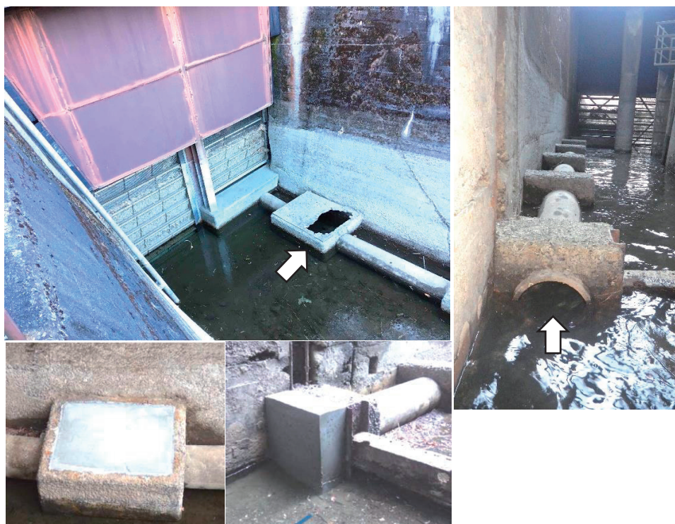
図2 西湖発電所取水路内「旧湖南水道」破損部（2019.1.28撮影）と補修後（2019.3.22撮影）
